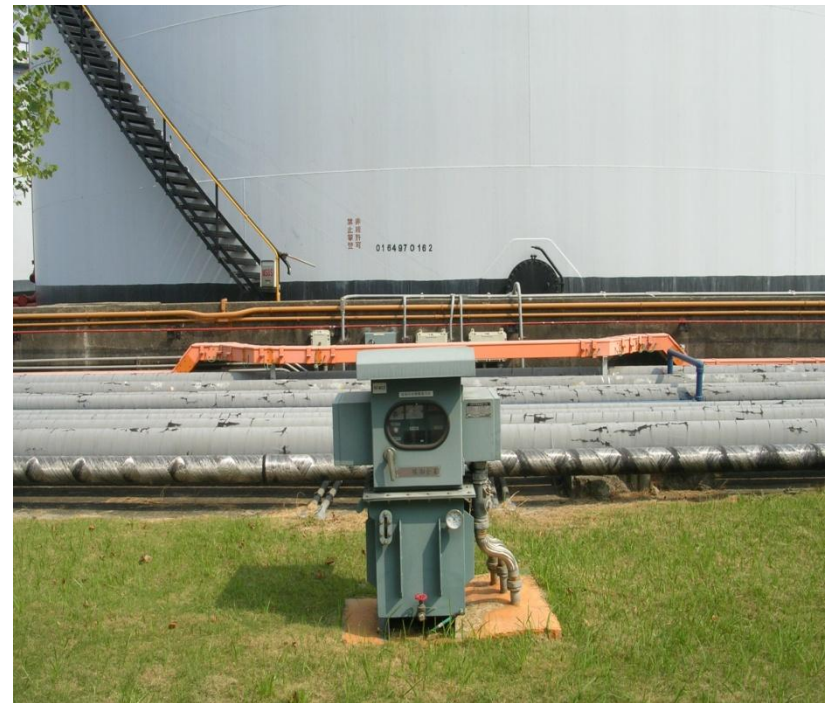
陰極防蝕主機設備
